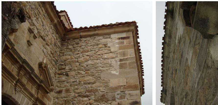
Fig. 32: Abombamientos en el muro Este
