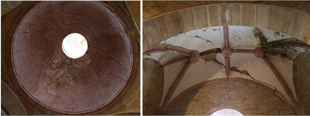
Fig. 35 y 36: Agrietamientos en cúpula y en bóveda Este
