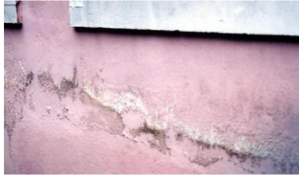
Figura 5 – Parede contaminada pelo lençol freático com sais.
