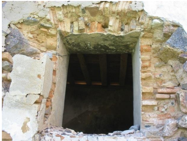
Figura 3 – Problemas patológicos ocasionados pela névoa salina
