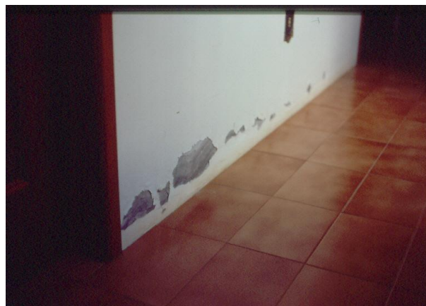
Figura 2 – Danos provocados numa parede com muita umidade
