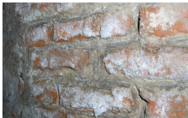
Figura 4 – Aparência de blocos cerâmicos contaminados por sulfato do lençol freático.
