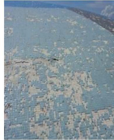
Figura 5. Fallos de adherencia del mortero y enchape de la cúpula
