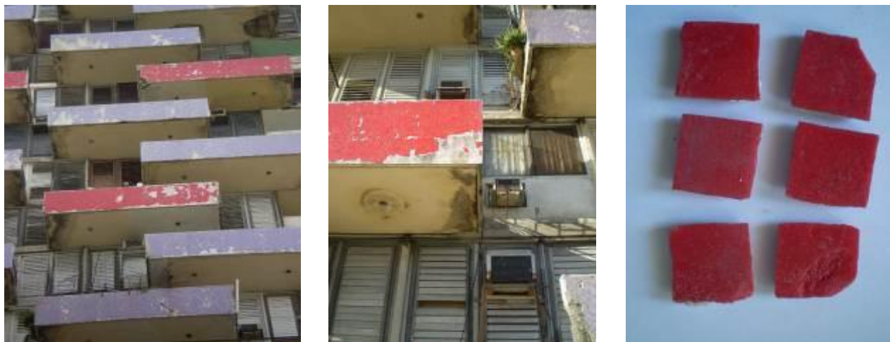
Figura 6. Procesos de deterioro del enchape cerámico de los balcones del Edificio del Retiro Médico
