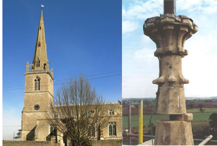
Fotografía 2. Iglesia de Easton Maudit en Northamptonshire, Inglaterra. Fotografía de la derecha: Daño causado por un impacto lateral de rayo.
