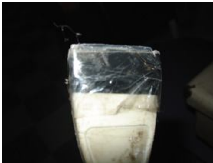
Foto 2. El mal estado de las instalaciones eléctricas es la causa principal de los principios de incendio en las instituciones culturales.
