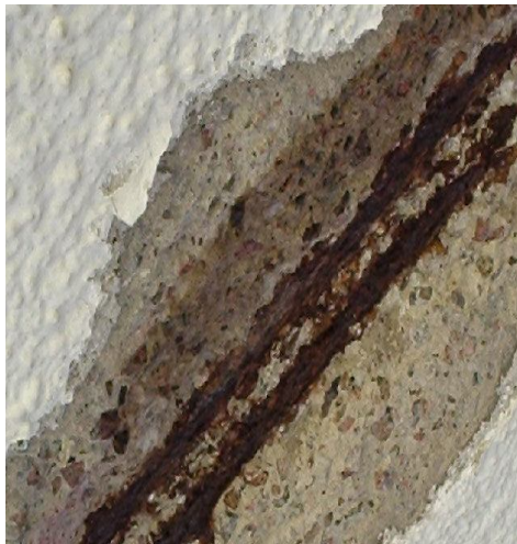
Fotografía 2. Dinteles con pérdida de hormigón
