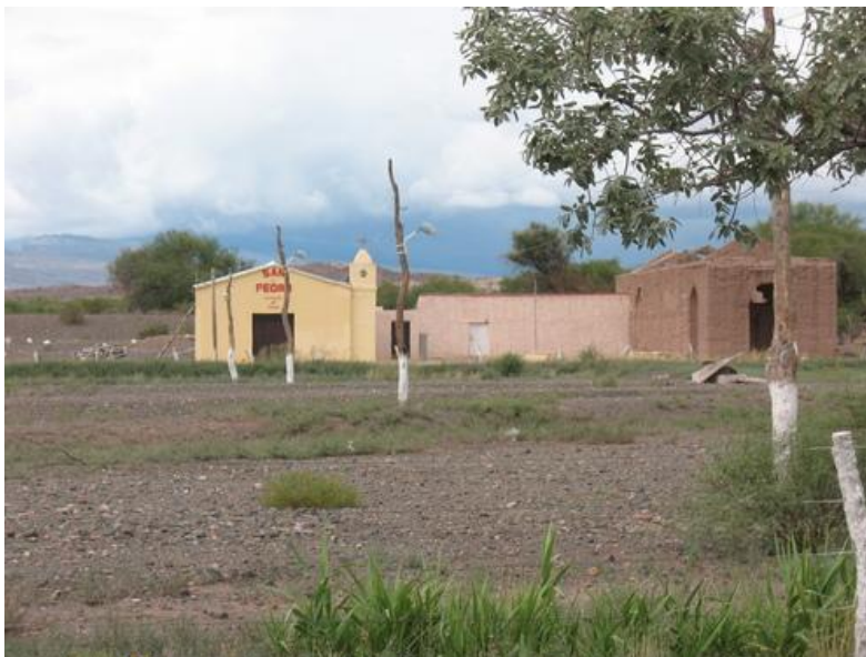
Fotografía 2: Iglesia de San Pedro, Jagüé, Departamento Vinchina. A la derecha la construcción del templo original realizado íntegramente en adobe con techumbre – derrumbada – en varas y cañizos apoyados en cabreadas de adobe. A la izquierda, se observa la capilla actual pintada de amarillo construida con materiales modernos de argamasa de H°A° y techo de chapa.
