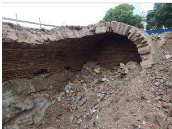
Fig. 5 Vista de la cisterna cuando el derrumbe
