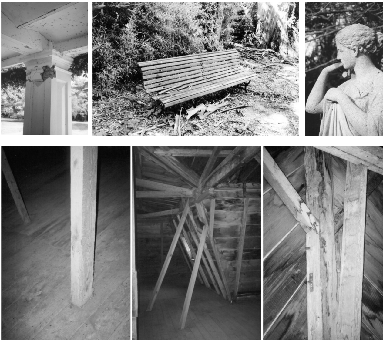
Detalle de patologías de la Casa Principal, Jardines y elementos de madera de sosten del techo.
