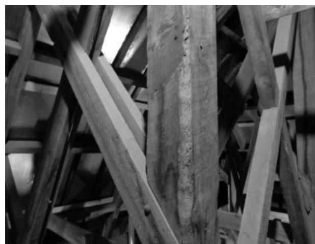
Detalle de un elemento estructural de la cúpula. Se observa la afectación por la presencia de insectos
