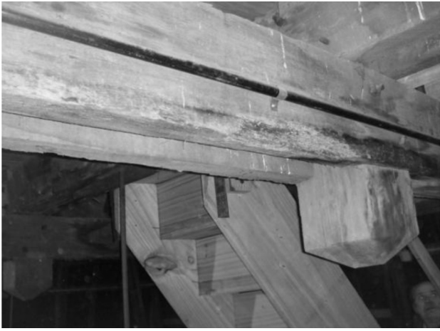
Detalle de viga fuertemente afectada por presencia de insectos.
