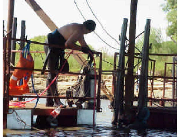
Foto Nro. 11 Relevamiento de buzos especializados para determinar el deterioro de las fundaciones.
