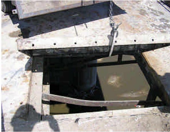
Foto Nro. 18 Método de desarme de las planchas de piso de hierro batido
