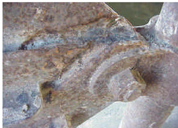
Foto Nro. 13 nudos corroídos
