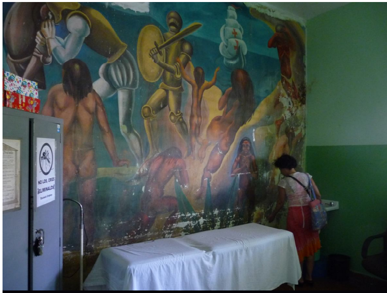
Fotografía 3. Los murales del primer piso representan escenas de la historia nacional, como éste de la Conquista, en el Dispensario Médico. Viviana Domínguez observa el daño causado por el roce del mobiliario.
