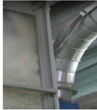
Figura XII.22. Ingreso del algodón al sector de desmote a través de conductos. (Elías, 2015).
