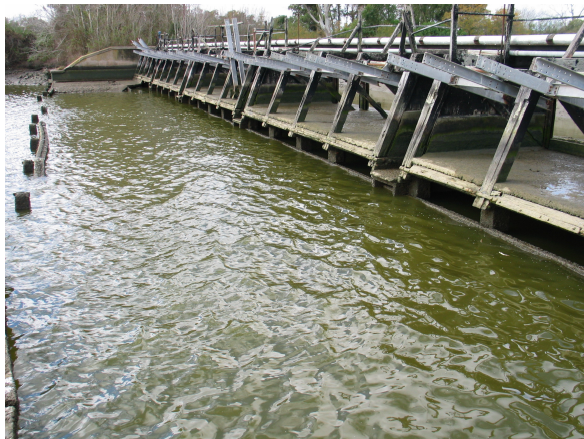
Foto N° 2: Vista aguas arriba, se observan restos de la estructura de montantes de madera dura, perfiles de hierro zincado, de los marcos de las compuertas automáticas y, restos de pilotes y viga transversal de cierre del blanquet de restitución, sobre la Ría.
