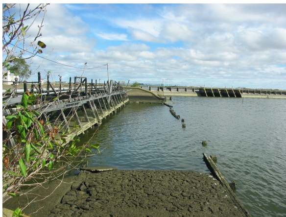
Foto N° 8: Restos de la losa de Blanquet de aguas abajo.
