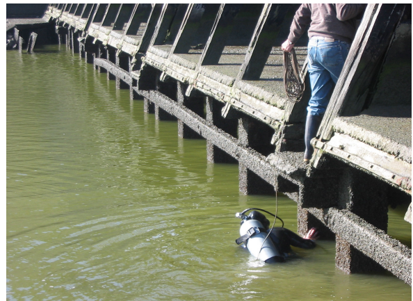
Foto N° 9: Inspección subacuática del estado de la infraestructura, pilotes, vigas transversales y entablonados.
