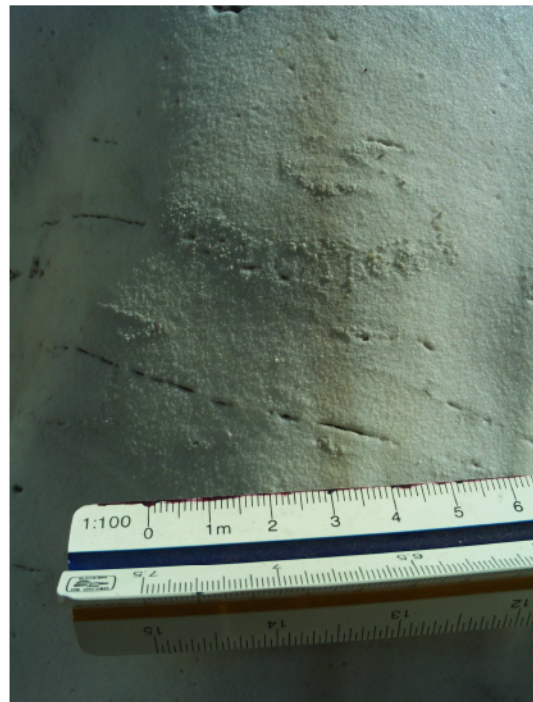
Fig. 6: Eflorescencias/fisuras - Gral. L. M. Campos
