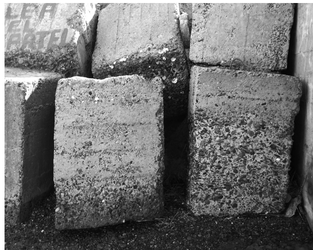
Bloques de protección atacados por sulfatos en zona de fluctuación de marea.
