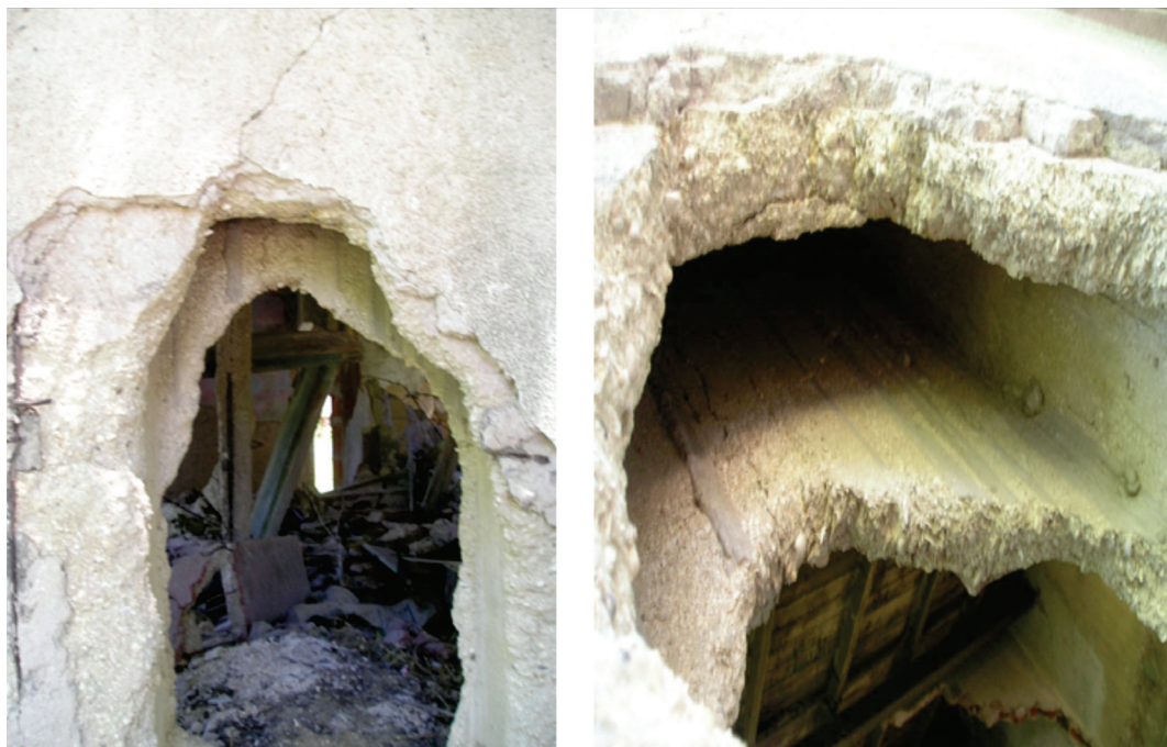
Figura 7: Muro exterior de una vivienda (derrumbada en gran parte), donde se observan las dos placas murarias de hormigón (fotografía enero 2007, vivienda ubicada sobre calle 165, Mz. 54a, parcela 16).
