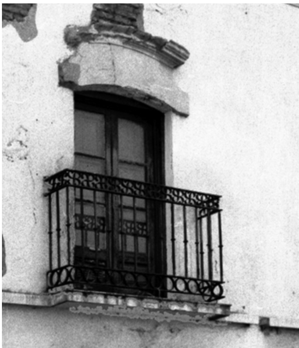
Figura 41: Detalle decorativo sobre el cerramiento de la puerta balcón, Casa llamada de Rivadavia.
