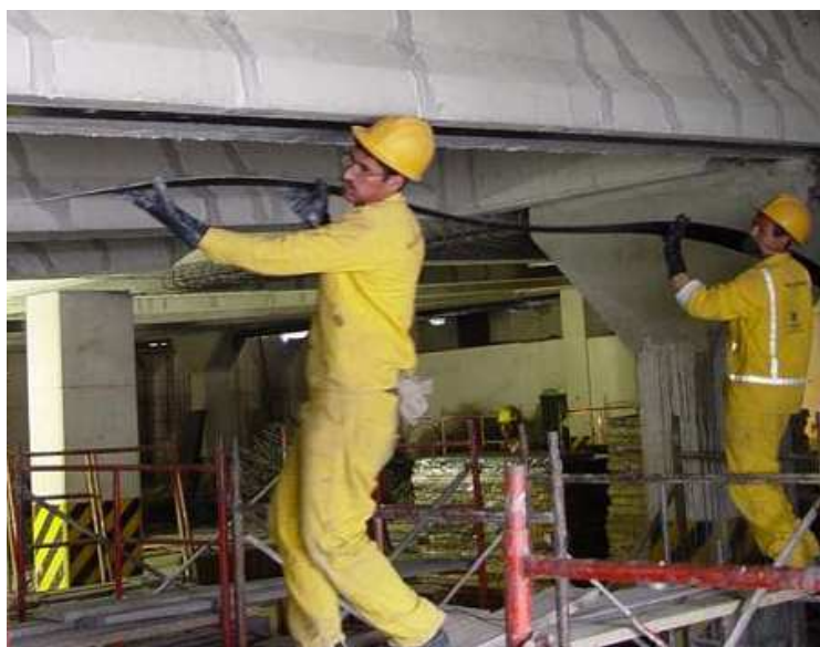
Figura 4: Viga de hormigón armado reforzada con fibras de carbono precuradas
