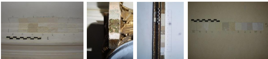
Figura 3: Foyer principal. Las muestras son de izquierda a derecha: 1- cielorraso moldura, 2- voluta columna, 3- moldura muro, 4- muro parte superior.
