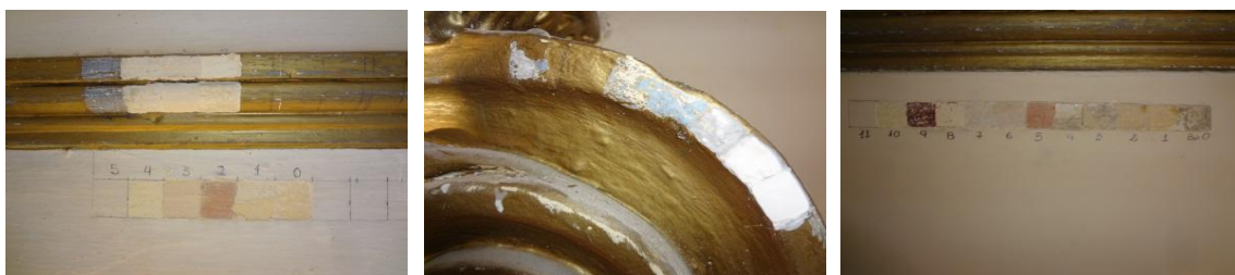
Figura 4: Salón Dorado. Las muestras son de izquierda a derecha: 1- muro moldura, 2- voluta pilastra, 3- muro medianero puede verse la textura de pinturas a la cal hasta la quinta capa.
