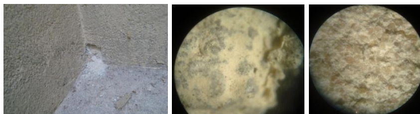
Figura 9: Muro de fachada en primer piso, área Balcón. Microfotografías- Izquierda: Vista superficial 25X con restos de pintura a la cal. Derecha: Corte transversal 25X.
