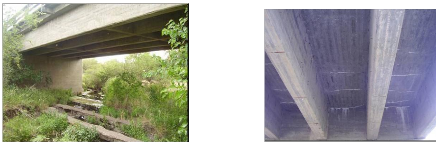
Fig. 5 Vista inferior del puente entre pilas uno y dos (Izq.). Y Vista de fisuras en el tablero superior con procesos visibles de lixiviación. En vigas se observaron hierros afectados por corrosión (der.).
