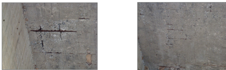
Fig. 10 Vista de la cara inferior del tablero del puente, donde se observan la falta de recubrimiento.
