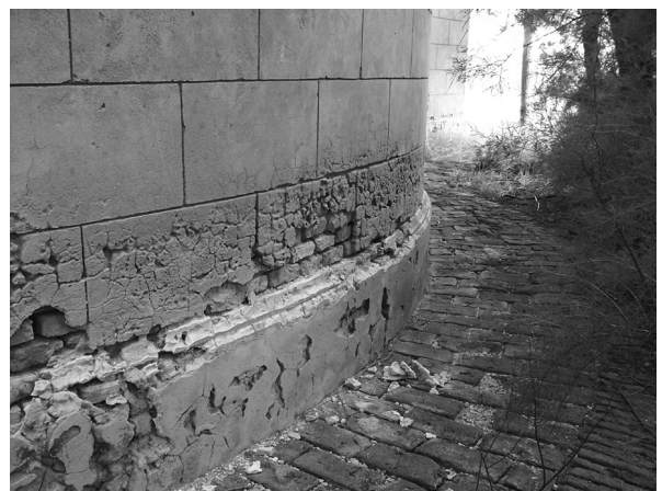
Imagen 1: Vista de revoques alterados por circulación de aguas sulfatadas.
