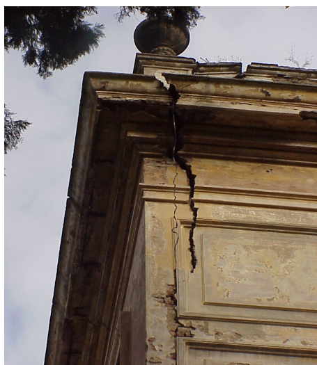
Fisura próxima a calle 4
