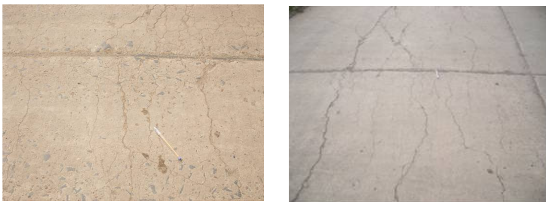
Figura 6. Aspecto superficial de dos losas de pavimento afectadas por RAS donde se observa el cuadro de fisuración con desarrollo longitudinal.
