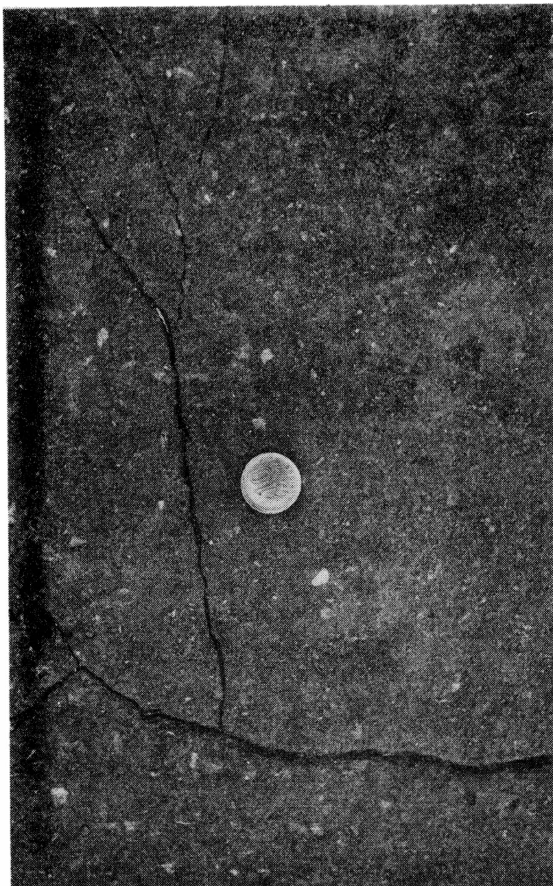
Fig. 1b.-- Fisuras debidas a la contracción de la carpeta
