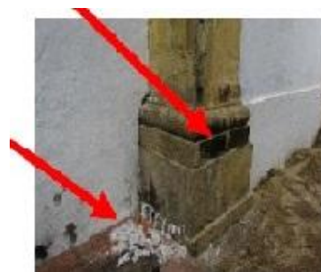
Figura 4: Registro fotográfico, feito por Teles em 2016, de danos causados por velas acesas. Fonte: [10].
