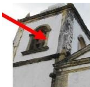
Figura 3: Registro fotográfico, feito por Teles em 2016, de prováveis eflorescências provenientes da alta porosidade da pedra calcária. Fonte: [10].
