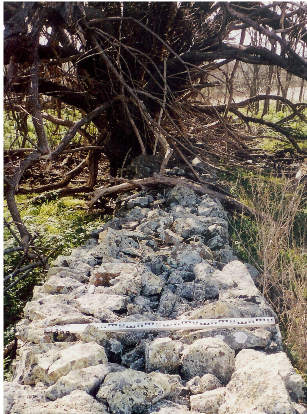
Figura 7. Pared de la construcción San Celeste I afectada por árboles.
