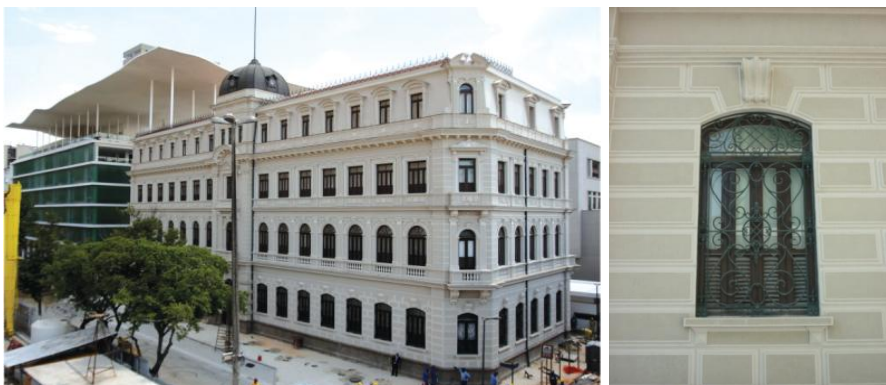
Figura 11 - 12: Fachada restaurada / Detalhe de janela obstruída por painel interno (Fonte: Karina F. de Almeida)
