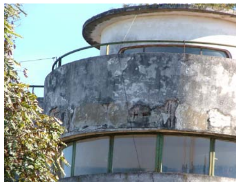
Figura 24: Detalle de un sector del edificio. Se observa la degradación del mortero.
