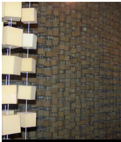
Imagen 9: Detalle de una de la cámara anecoica.
