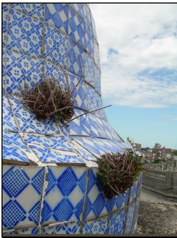
Fotografía 12- Crecimiento vegetal sobre revestimiento.
