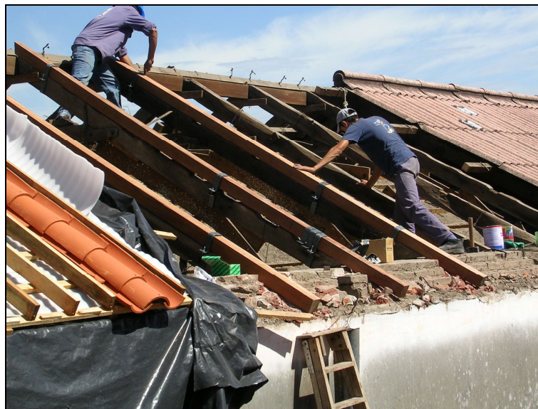
Fotografía 6- Trabajos de refuerzo de la estructura original de pares y nudillos. La foto muestra el avance a lo largo de la nave principal de adelante hacia atrás con el mecanismo de refuerzo de la estructura original.
