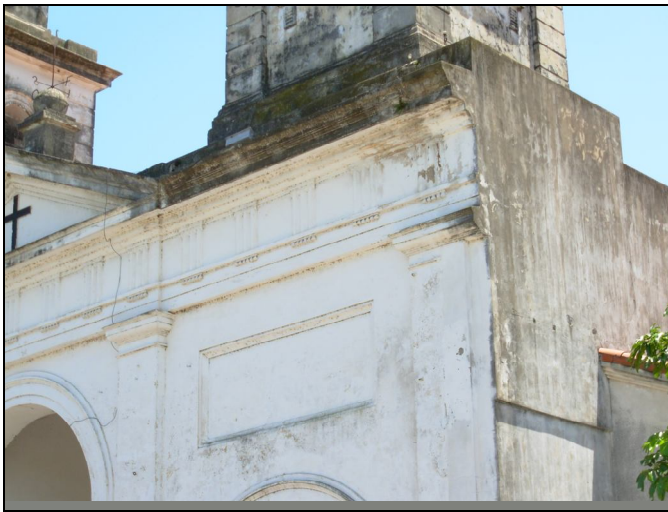
Fotografía 19- Esquina este en su falta de terminación producto de la demolición de un antiguo edificio en tiempos pasados.
