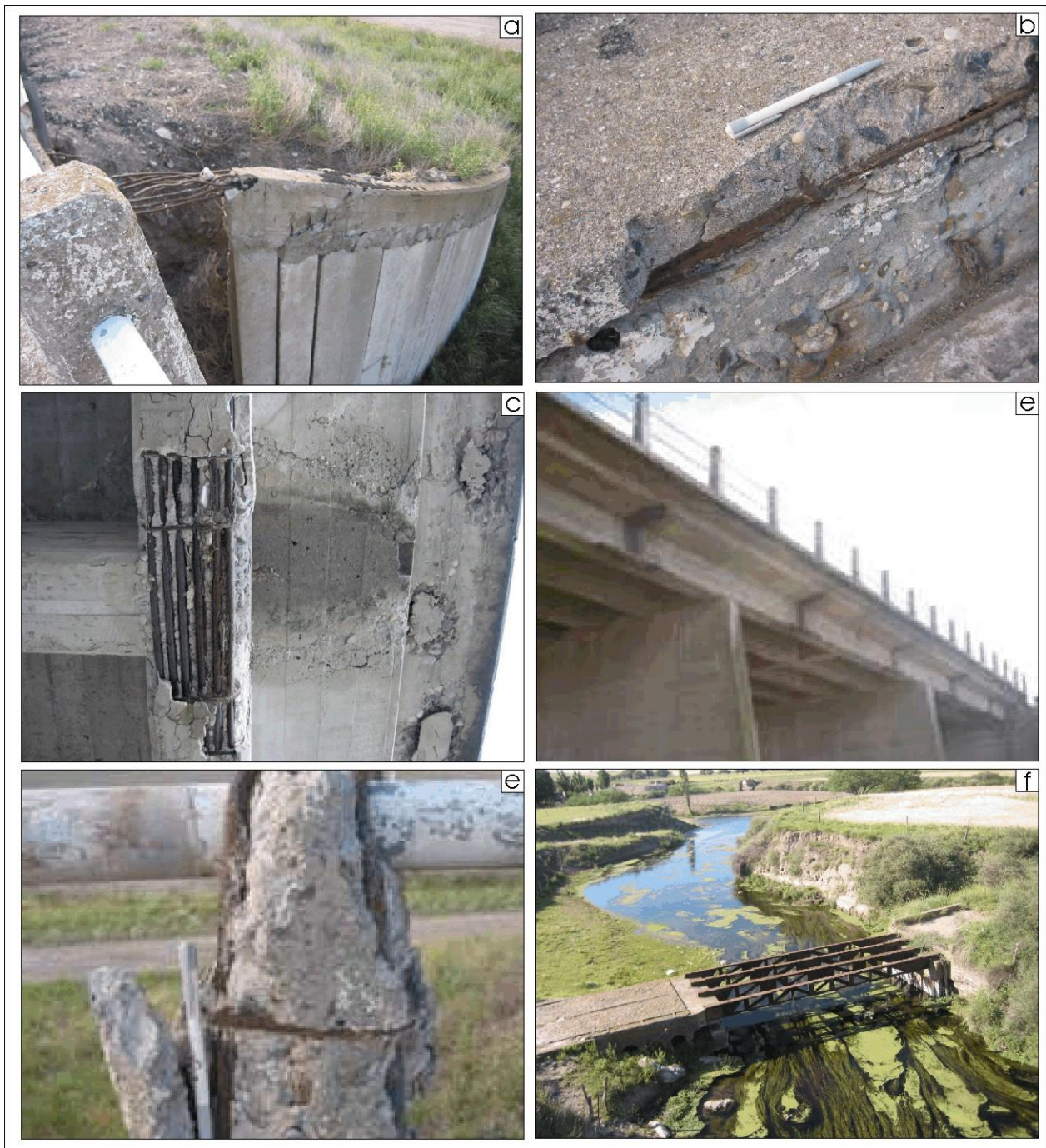
Figura 2. a: Muro de vuelta. b: losa de tablero. c: viga en correspondencia con un drenaje. d. diseño inadecuado de drenajes. e: corrosión en soporte de baranda vehicular. f: puente antiguo, fuera de servicio.
