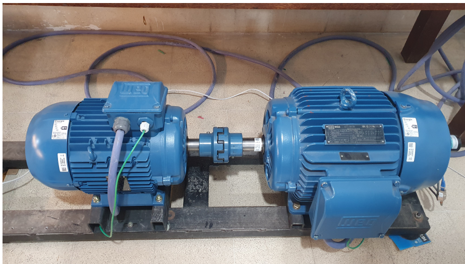
Figura 3.3: Máquinas acopladas mecánicamente. Izquierda, máquina de carga. Derecha, máquina de impulsión.
