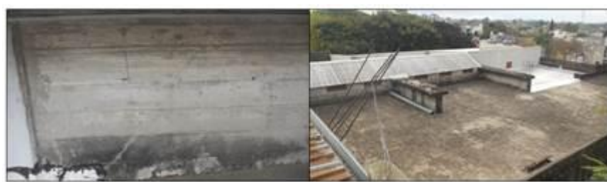
Figura 3: Fisura de corte en viga "T" (izq.). Terraza y vigas "T" (der.).
