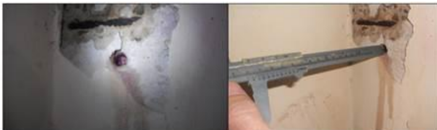
Figura 13: Aplicación de fenolftaleína en columna 2do piso (izq.) y Medición de carbonatación (der.).
