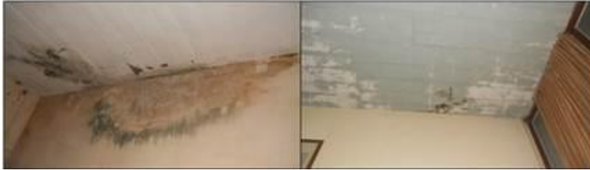
Figura 8: Lixiviación y filtraciones de agua de lluvia (izq.) y Filtraciones de agua en losa sobre 2do piso (der.).
