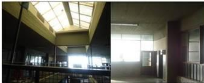
Figura 4: Vista del patio central del 1er piso (izq.) y Vista de la losa en el pasillo principal (der.).
