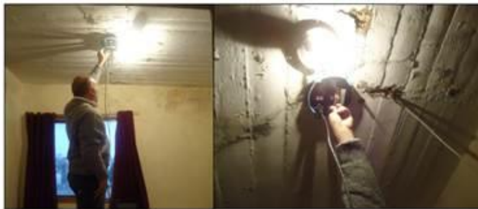
Figura 6: Medición de corrosión con GECOR 6 (izq.) y Medición con GECOR 6 en losa sobre 2 do piso (der.).
