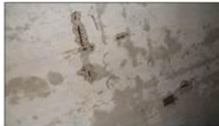
Figura 7: Losa del 2do piso con corrosión de sus armaduras, desprendimientos de hormigón dejando a la vista el poco recubrimiento dado a las armaduras.
