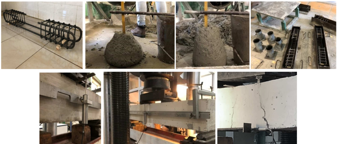
Figura 3: Hormigonado y dispositivos para el ensayo de las vigas de hormigón armado.
