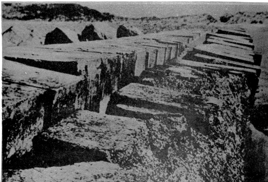
Fig. 19.- Bloques de hormigón de cemento portland normal sometidos a la acción del agua de mar y dañados por una reacción árido-álcali (Imre Biczok, 2)
