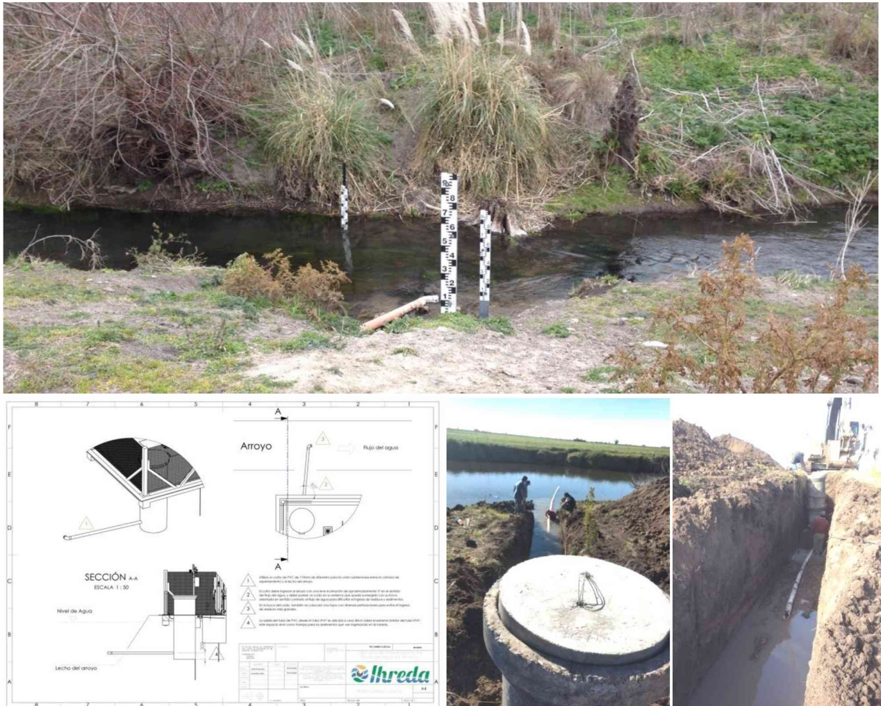
Figura 8b. Escalas hidrométricas en EM43 (arriba) y plano de la cámara de aquietamiento junto a una foto de desarrollo de la obra en EM32 (abajo).
