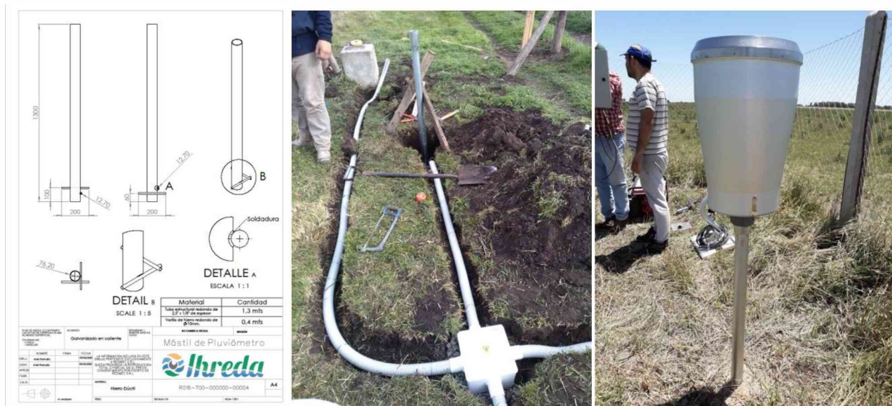
Figura 11. Plano del mástil del pluviómetro (izquierda), cañerías en desarrollo con cajas de inspección (centro) y pluviómetro instalado (derecha).
