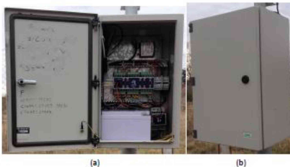
Figura 4. (a) Datalogger montado en gabinete apropiado. (b) Tapa de gabinete cerrada para garantizar estanqueidad
