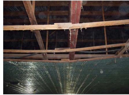
Figura 10 – Estado de la estructura
