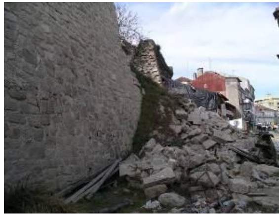
Figura 5. Disposição da ruína, decorrente de mecanismos indiciadores de subsidência da fundação.
