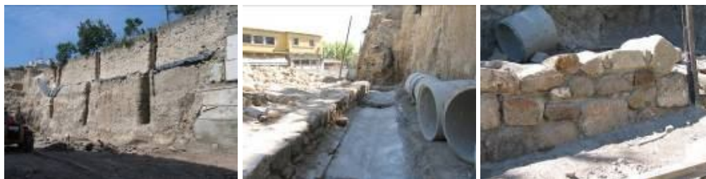
Figura 14. Execução de drenagens transversais e paralela à muralha. Pormenor do arranque do paramento da muralha.
