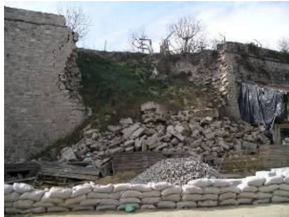
Figura 3. Segunda derrocada da muralha de Chaves (2004).
