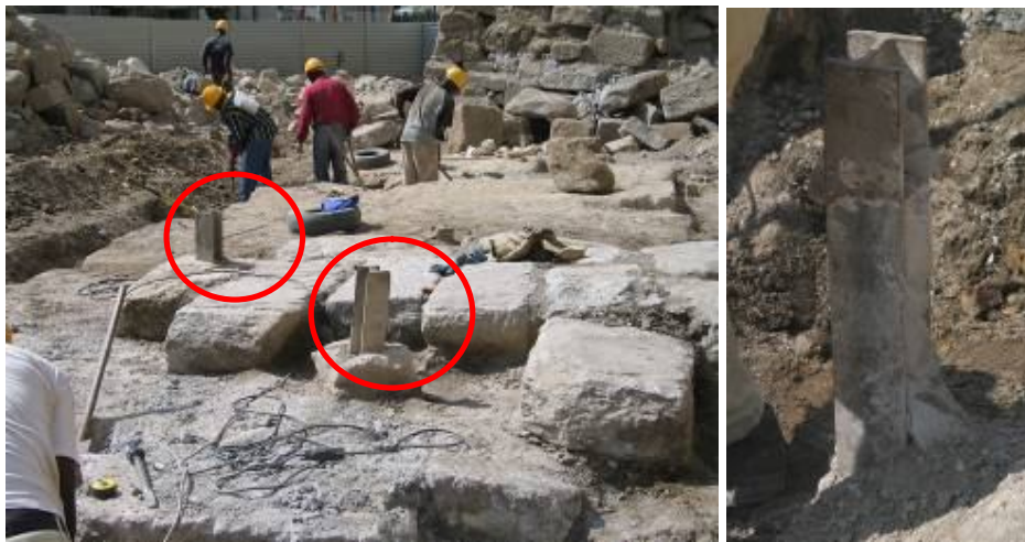
Figura 4. Colunas de jet-grouting armadas para reforço das fundações da muralha de Chaves.
