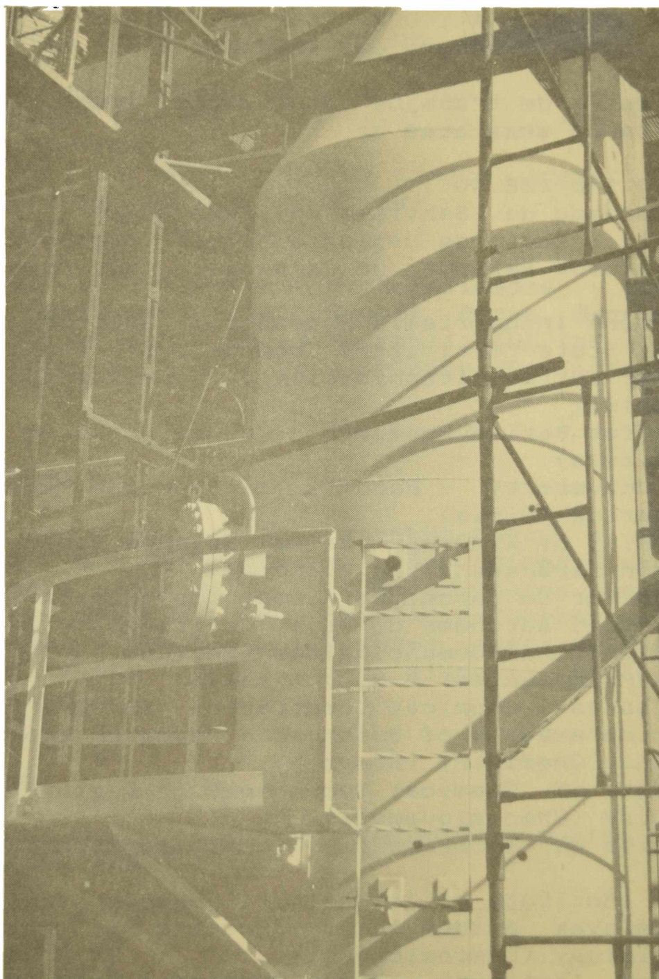
Tanque de presurización de MALEIC S.A.; se diseñó la protección interior (resistente a la acción directa de vapor de agua a presión) y la exterior (calor seco y agresividad del medio ambiente).
