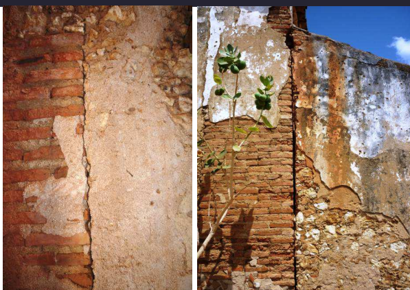
Figura 5 – Detalhes das fendas no interior e exterior da Capela
