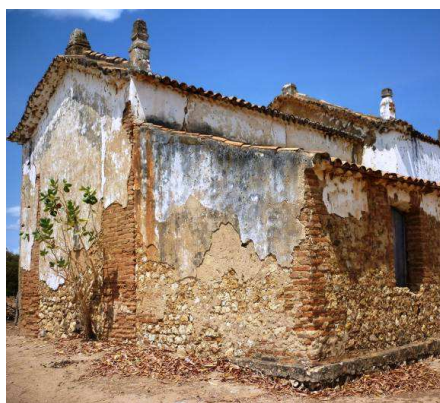
Figura 6 – Lacuna de revestimento nas fachadas da sacristia e da capela-mor
