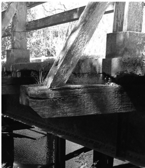
Figura 9: Gramíneas creciendo sobre los travesaños.
