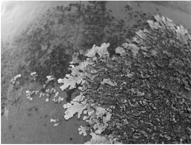
Figura 10: Se observa un trozo de teja colonizada.
