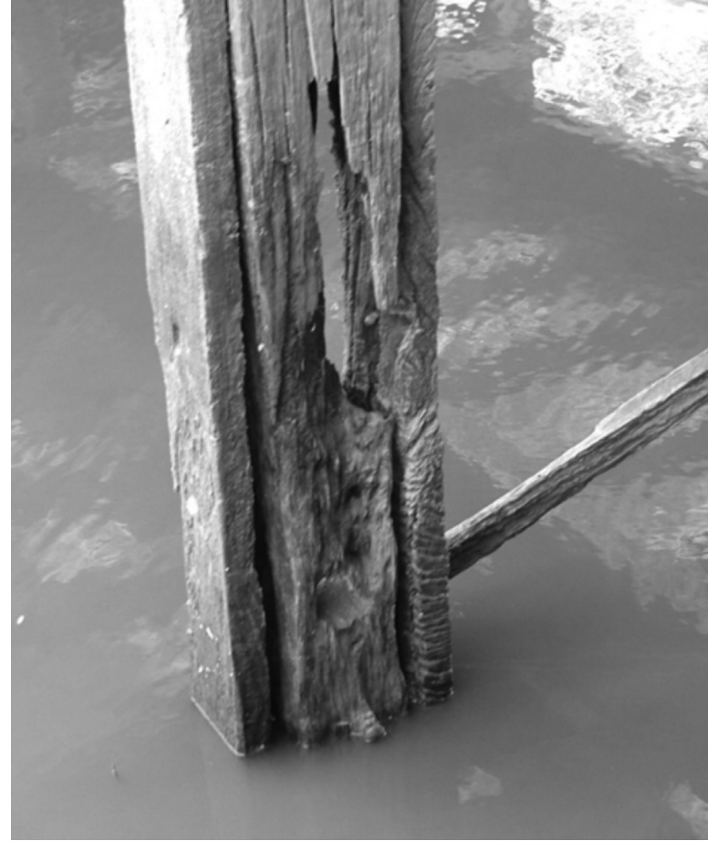
Figura 6: Estado de las columnas de madera.
