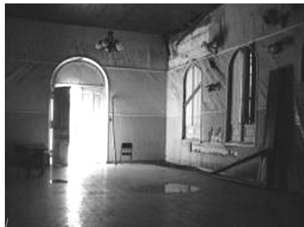
Figura 50: Interior del teatro inundado por la lluvia.
