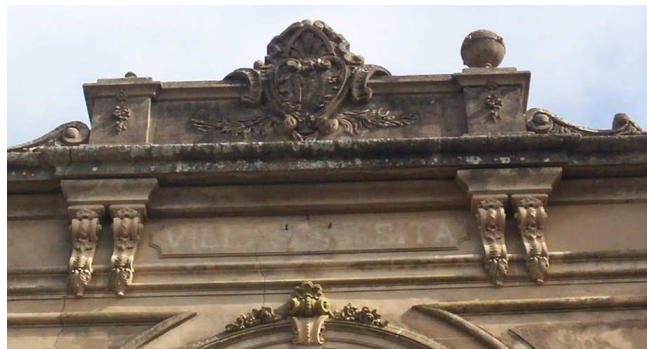
Figura 5: Marcas de molduras. Ausencia de copón superior izquierdo e inferior derecho.
