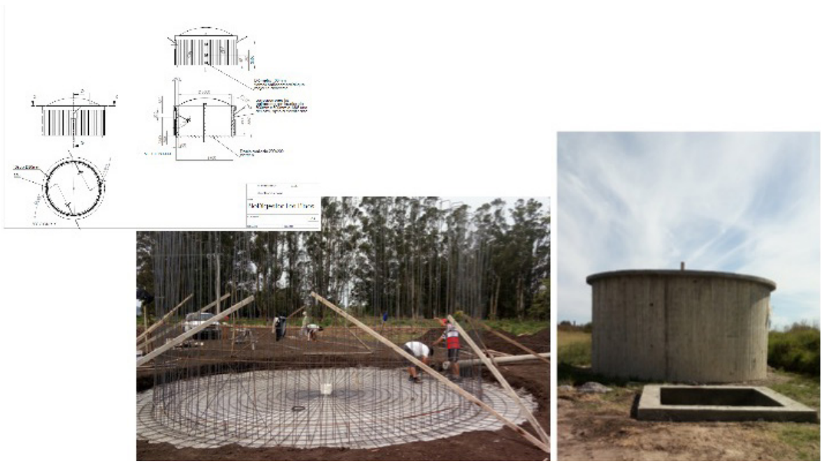
Etapas de plano, inicial y final de la construcción del biodigestor en Los Pinos
