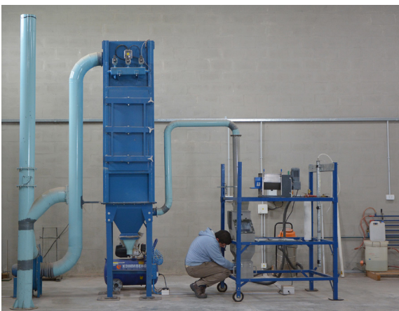
Planta separadora de material particulado
