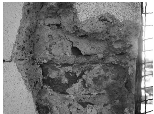
Detalle de una fisura que atraviesa el revoque y se continua en los mampuestos.
