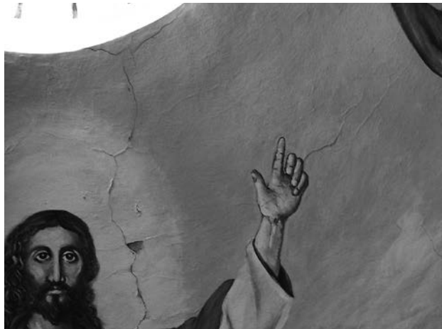
Detalle de fisura desarrollada en la bóveda de cañon corrido del ábside.
