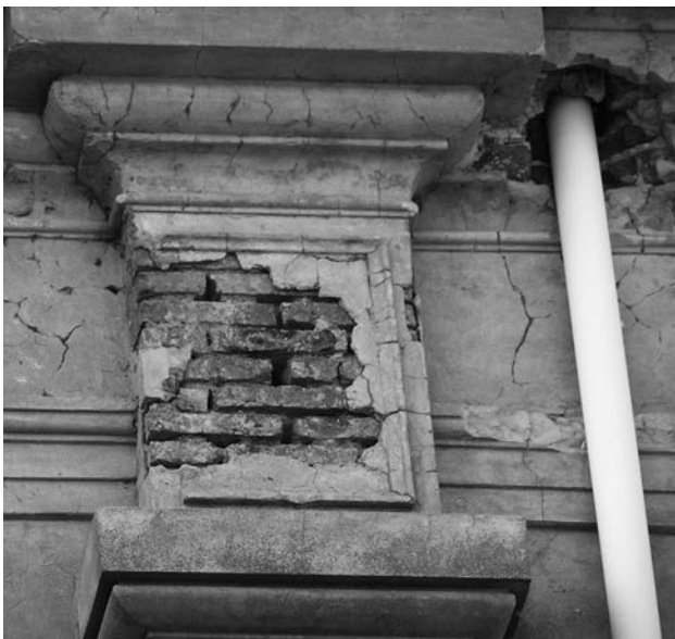
Detalle de una pilastra del exterior de la iglesia. Se observan los caños de pvc en reemplazo de las bajadas originales.
