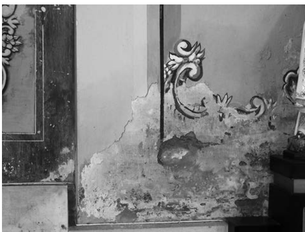
Vista de la degradación de los muros, arcos y bóvedas. Se observan desprendimientos de los morteros por falta de cohesión, alteraciones en las pinturas y ornamentos.
