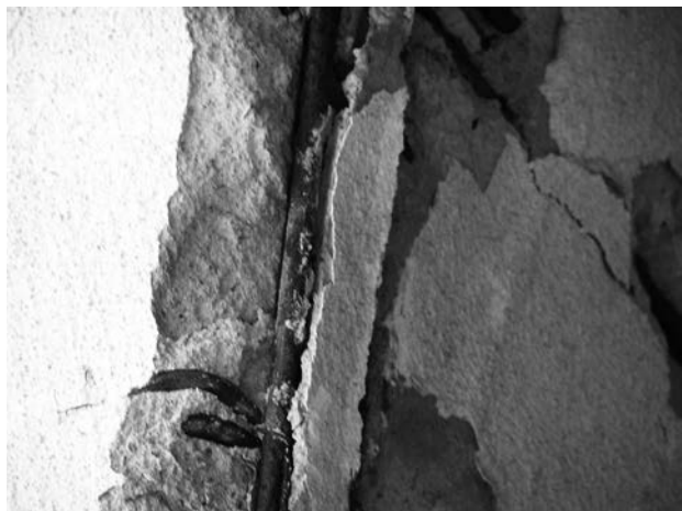
Detalle del interior de la Iglesia. Se observa el hormigón de recubrimiento insuficiente.
