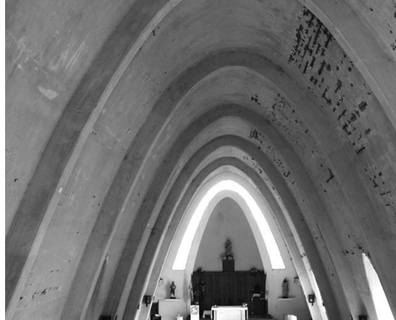
Vista del interior de la Iglesia. Se observan desprendimientos del hormigón de recubrimiento.
