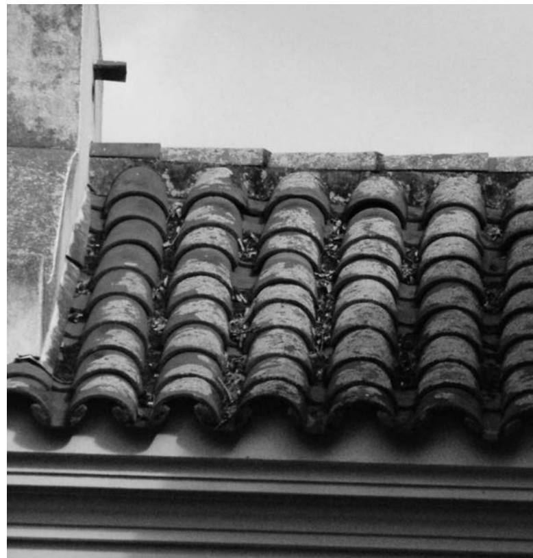
Detalle de la cubierta de tejas. Se observa la presencia de colonias de líquenes.
