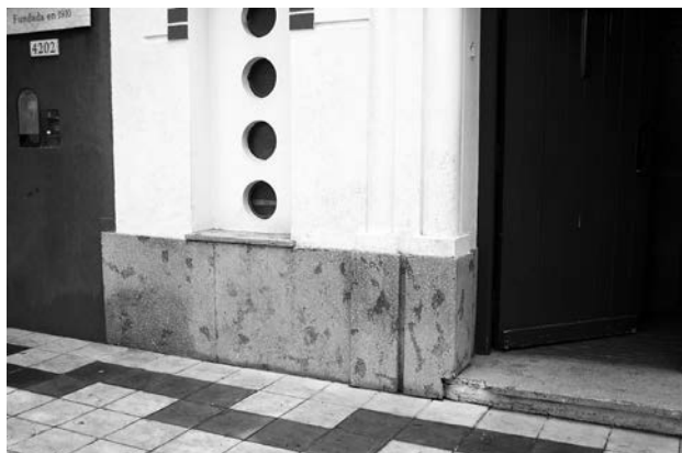
Detalle de la puerta de entrada. Se observa crecimiento biológico.
