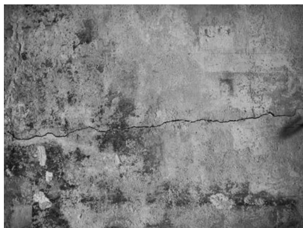
Detalle de la fisura sobre la bóveda de la Nave Central.
