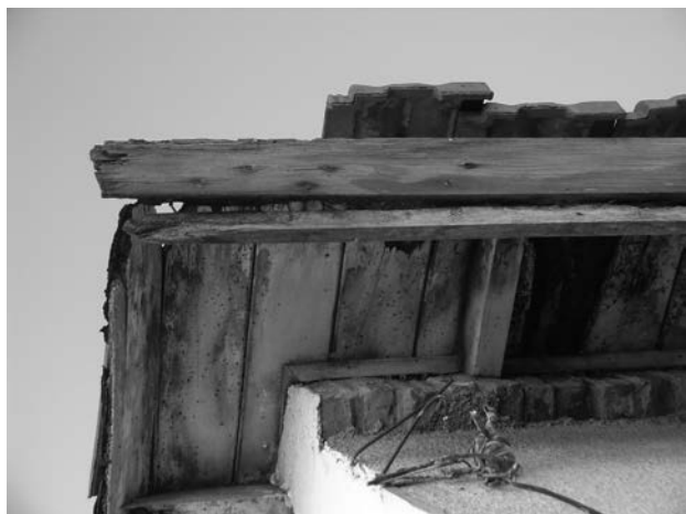
Detalle de la cubierta afectada por carcomas.
