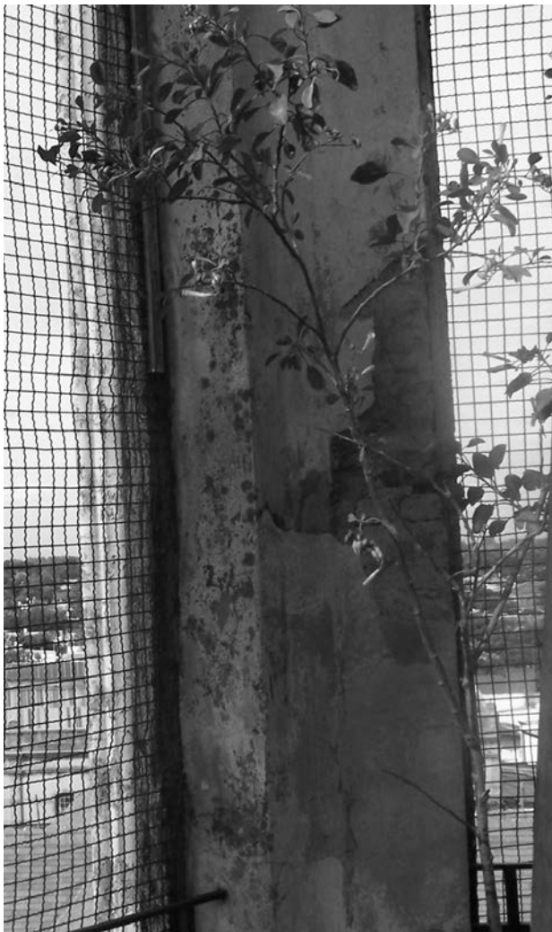
Detalle de un pilar del campanario. Se visualiza el crecimiento de una planta en el interior del campanario.
