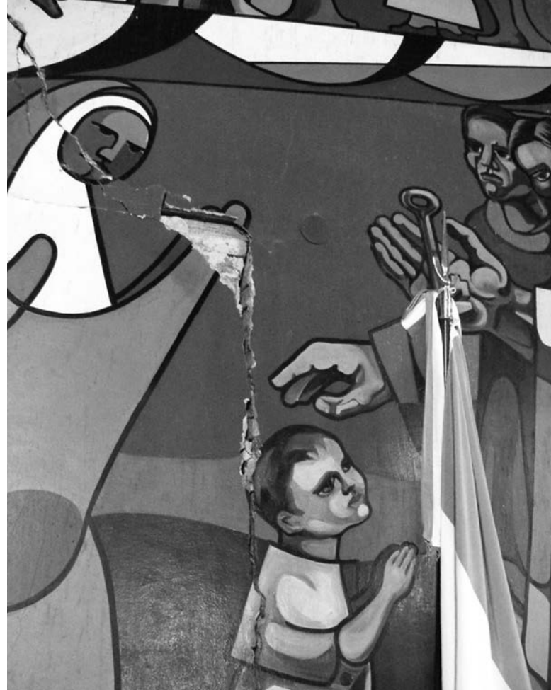
Detalle de fisura en el interior de la Iglesia.
