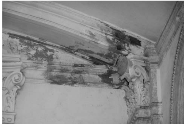
Detalle de un sector del altar. Se observan manchas por filtraciones desde la cubierta.
