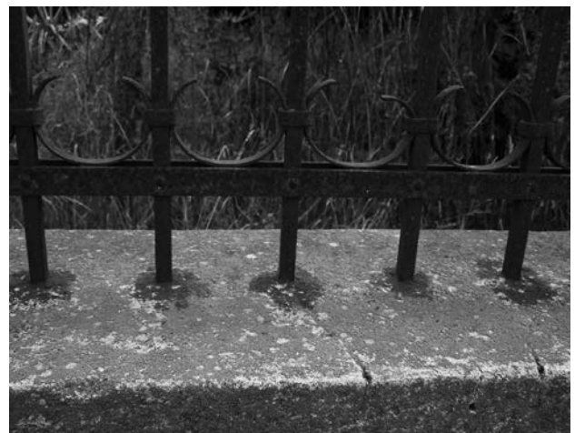
Detalle de un sector de la reja perimetral. Se visualiza la colonización líquénica sobre el revoque del muro.
