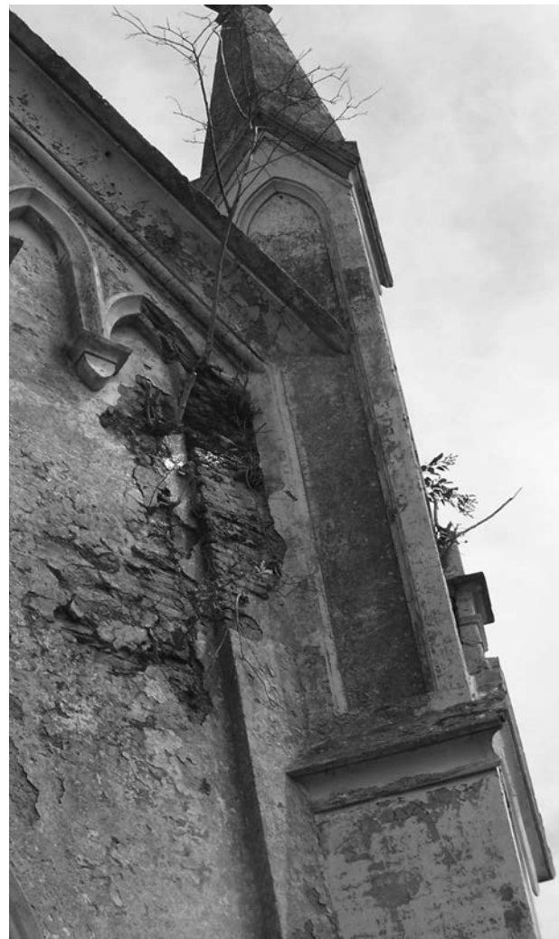
Detalle de un sector de la iglesia. Se observa el crecimiento de plantas en fisuras o juntas de los mampuestos y se visualiza una fuerte degradación de los revoques.
