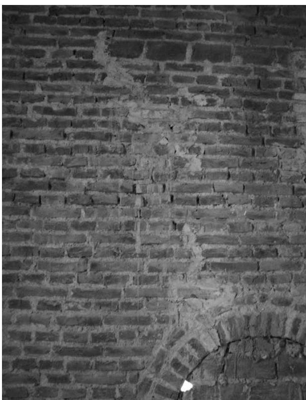
Detalle de una fisura sellada.
