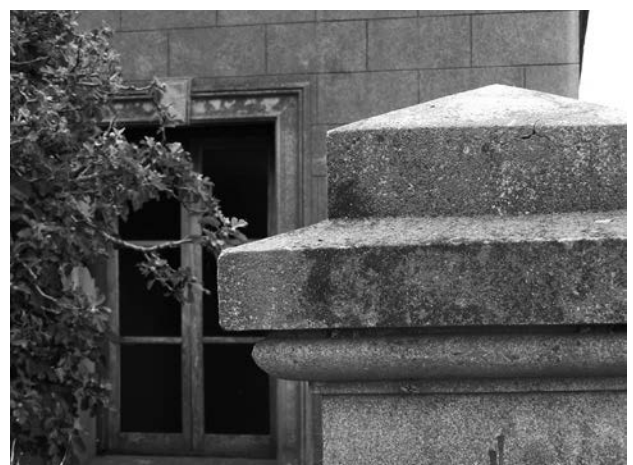
Detalle de un pilar. Se observa la colonización líquénica sobre los muros.
