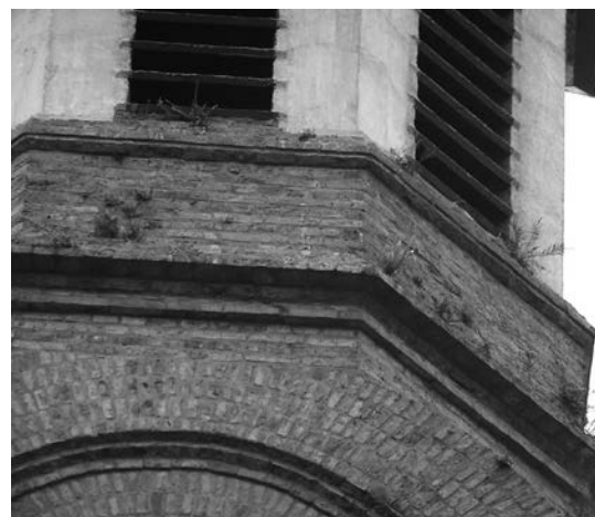
Detalle de crecimientos biológicos en la torre.
