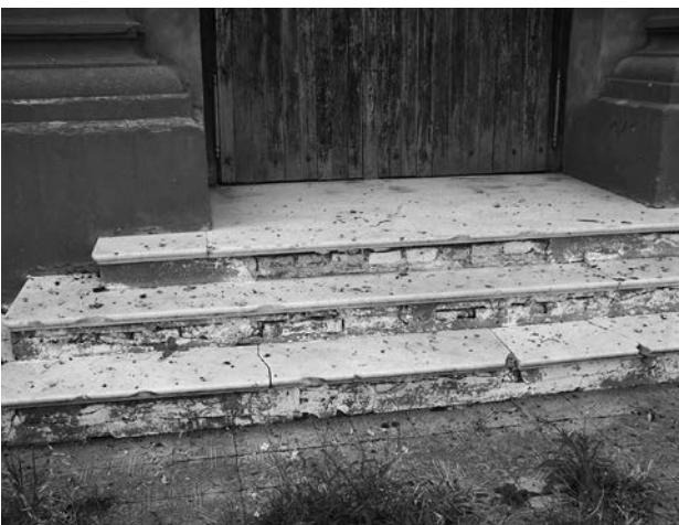
Detalle de la escalera de acceso. Se observa la fisura en uno de sus escalones.
