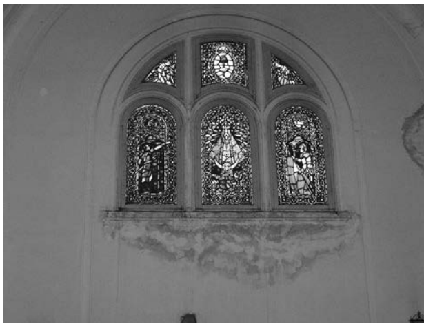
Detalle de filtraciones en aberturas. Iglesia Stella Maris.
