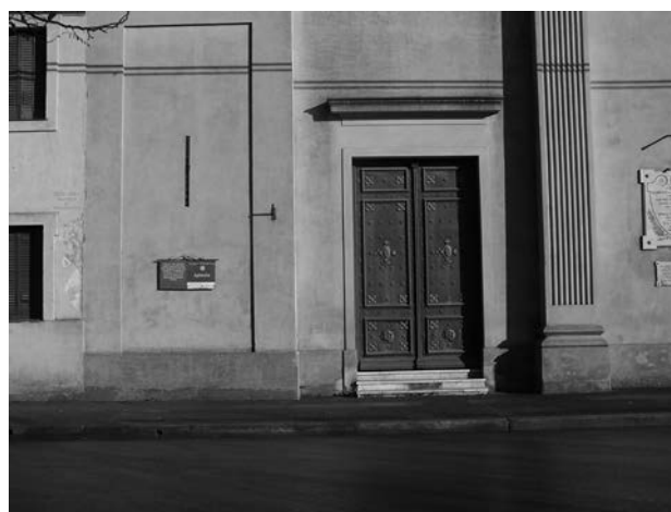
Detalle de muro exterior de la fachada. Se visualizan alteraciones en pinturas y manchas de humedad.
