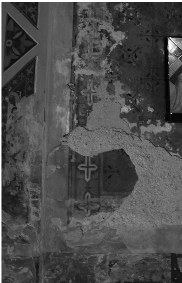
Detalle del interior. Se observan los desprendimientos de revoques por ascensión capilar.
