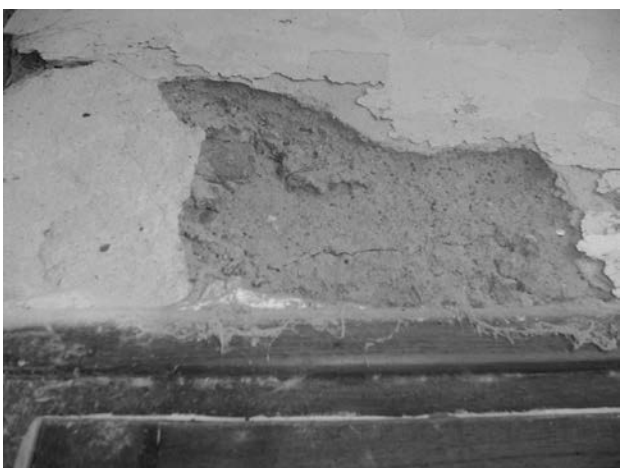
Detalle de desprendimiento de revoque por humedad ascendente
