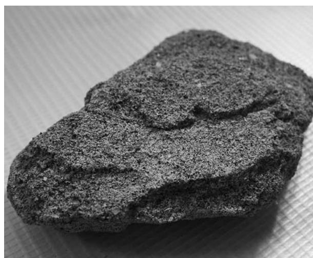
Revoque extraído a una altura de 800 mm (80). Se observa la disgregación superficial del material
