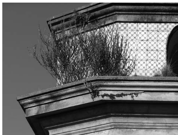
Detalle de un fuerte crecimiento de vegetación sobre las cornisas de la Cúpula y de la Torre del Reloj. Se observan desprendimientos de morteros y de las mayólicas de recubrimiento.
