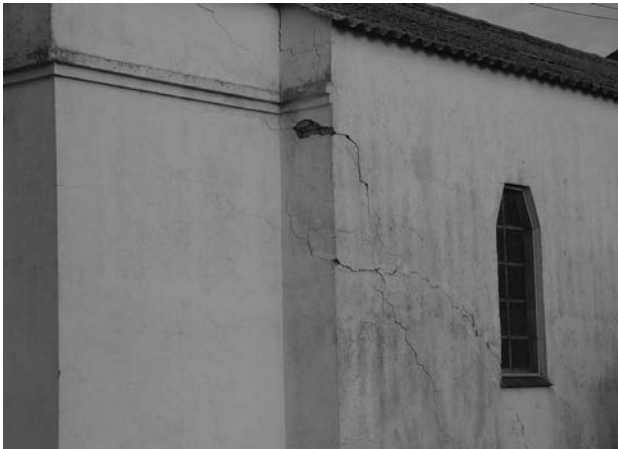
Detalle de fisuras en el muro exterior.
