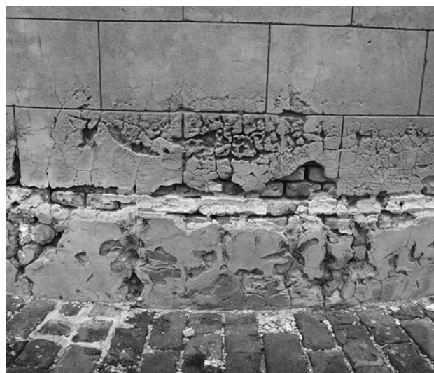
Detalle del muro exterior de la iglesia. Se observa la alteración y desprendimientos de los morteros.
