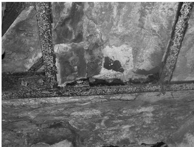
Detalle de las bovedillas. Se visualiza los perfiles metálicos con un avanzado proceso corrosivo y el desprendimiento de revoques de revestimiento.
