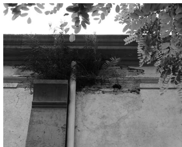
Crecimientos biológicos y desprendimiento de revoque.
