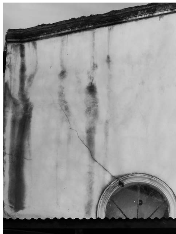
Detalle de fisura. Iglesia San Pedro. Villa Garibaldi. Partido de La Plata.
