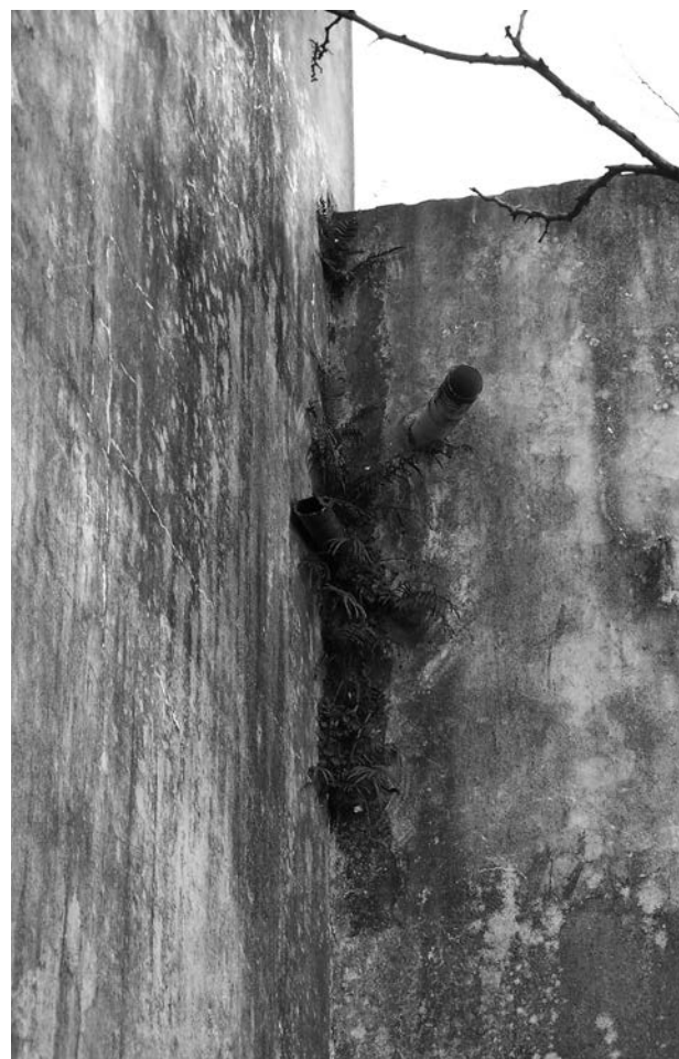
Vista de un sector de la fachada lateral izquierda. Se observan caños de los desagües pluviales sin la correspondiente bajada
