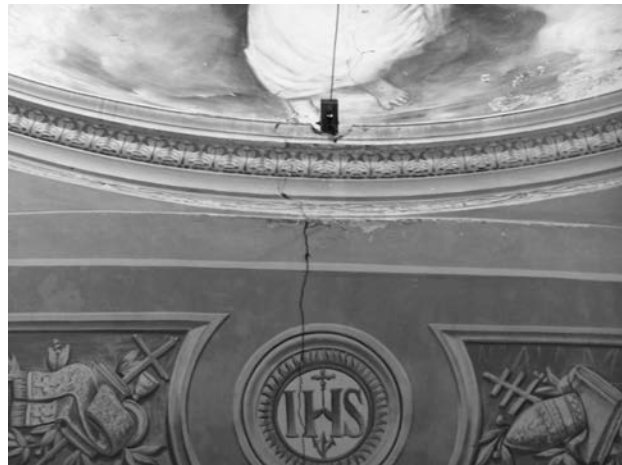
Vista de una fisura desarrollada en la clave del arco de una de las bóvedas de la nave lateral.
