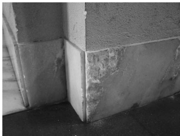
Detalle del zócalo. Se observa el mármol de revestimiento con eflorescencias.
