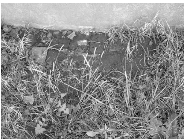
Detalle de la vereda perimetral. Se observa un fuerte crecimiento de hierbas y pastos.
