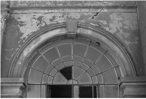
Detalle del arco de la puerta de ingreso a la galería. Se observa el desarrollo de una fisura en la parte superior del arco.
