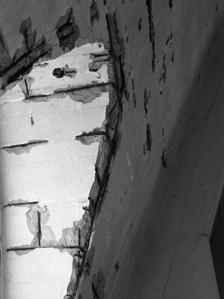
Detalle del interior de la Iglesia. Se observa armaduras expuestas con desprendimiento de material.
