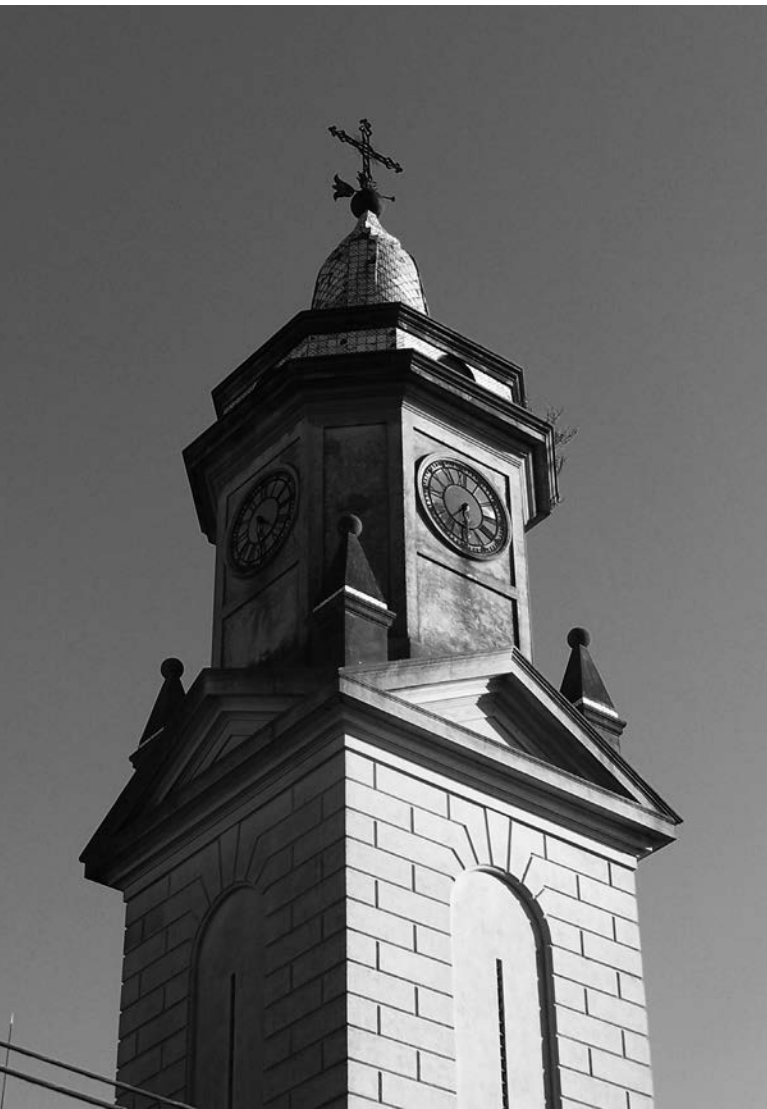
Vista de las Torres de la Iglesia, se observa colonización biológica sobre cornisas y ornamentos
