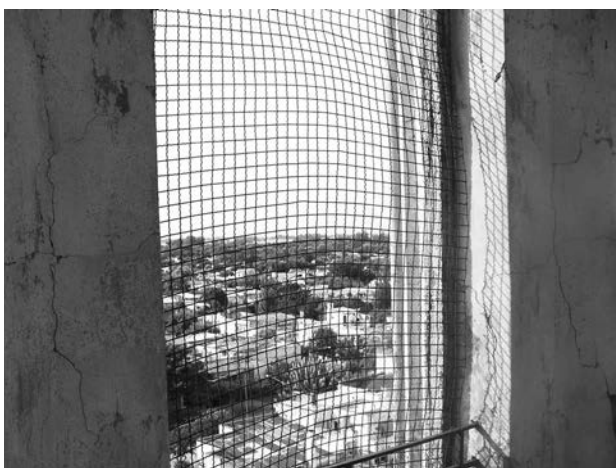
Detalle del esquema de fisuras horizontales que presentan los pilares del campanario. Se observa en particular una fisura transversal al elemento.
