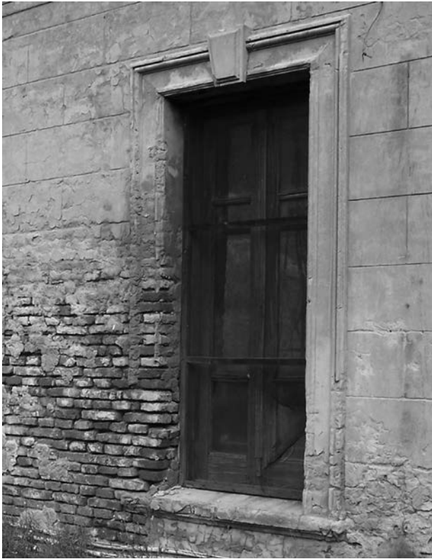
Detalle de muro externo de la casa parroquial. Se observa el desprendimiento del revoque por la degradación del mortero.
