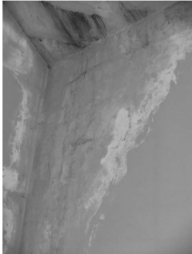
Detalle del interior. Se observan manchas de humedad por filtraciones de agua de lluvia.
