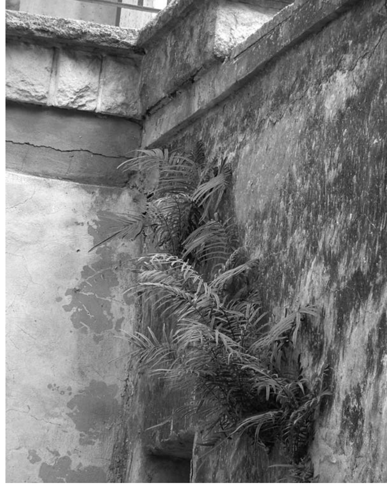
Detalle de un fuerte crecimiento de líquenes y vegetación.
