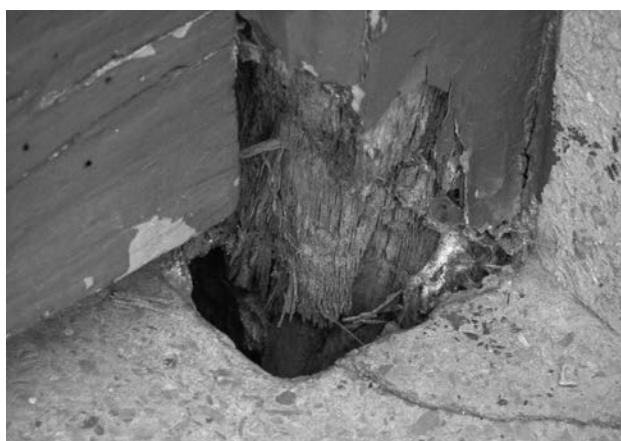
Detalle del marco de la puerta de madera. Se observa la degradación del material por la presencia de humedad.
