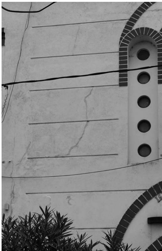
Detalle de fisuras en la fachada frontal.
