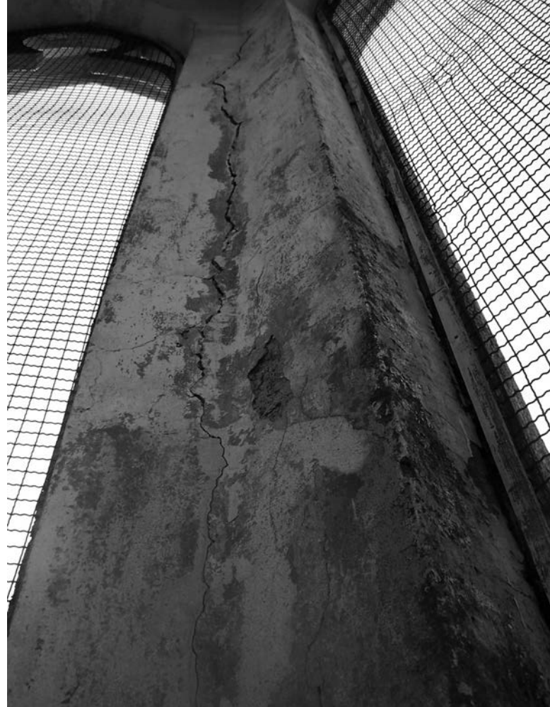
Detalle de fisura en columna de la torre de campanario. Iglesia Inmaculada Concepción. Partido de Lincol.
