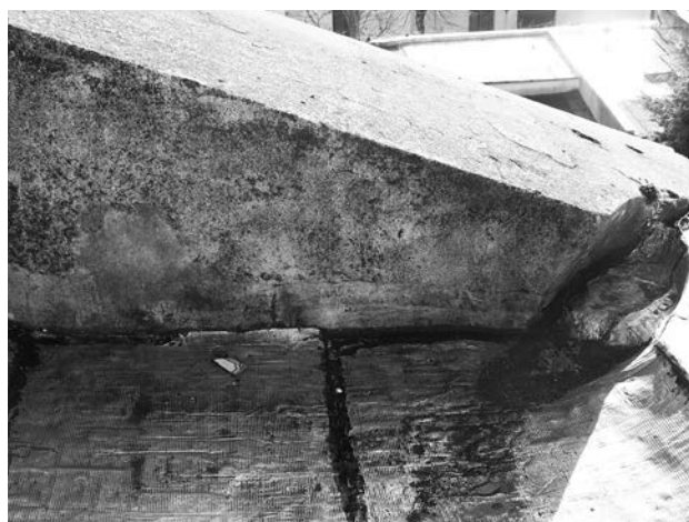
Detalle de la membrana asfáltica. Se observa la ausencia de solapes entre las laminas de la cubierta y de las cargas
