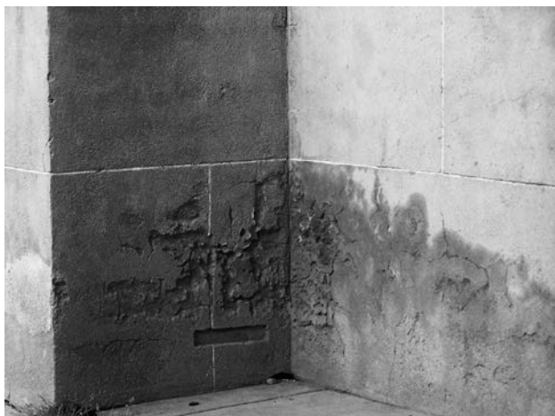
Detalle de humedad ascendente, Iglesia Ntra. Señora de La Merced. Localidad de Quequen. Necochea.
