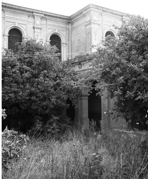
Vista de un sector de la iglesia. Se observa el crecimiento de plantas y arbustos.
