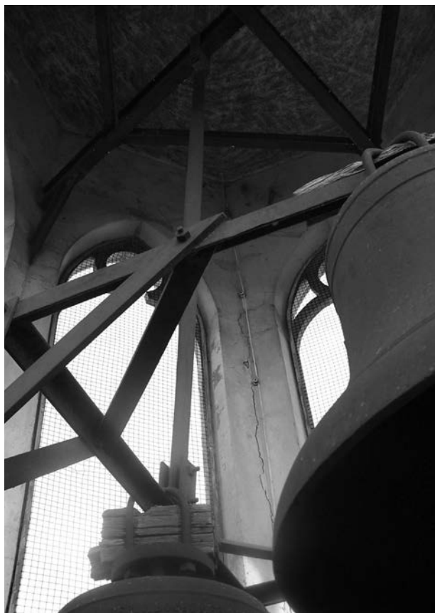
Vista de la estructura metálica que sostiene a las cuatro campanas. Se observa un proceso inicial de corrosión que no compromete a la estructura.
