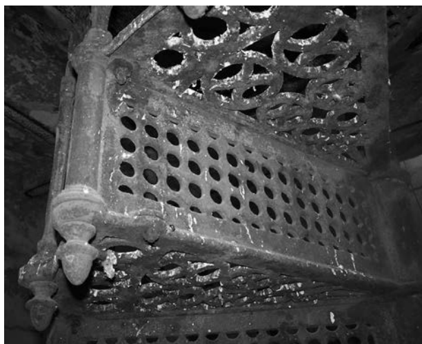
Detalle de la escalera metálica caracol, se observa un inicio de corrosión y la contaminación con guano de ave.
