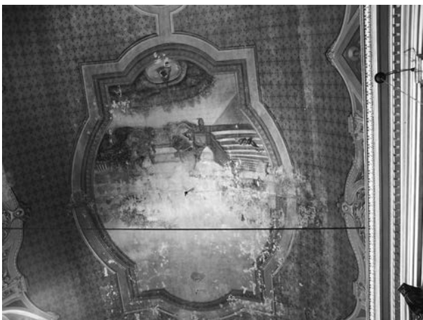
Vista de la fisura sobre bóveda de la Nave principal.
