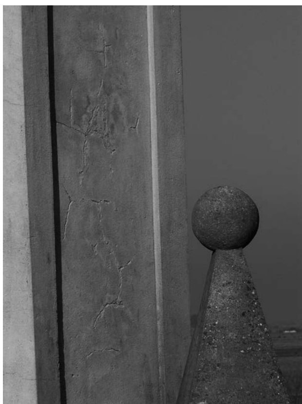
Vista de mapeo de fisuras sobre el mortero de terminación
