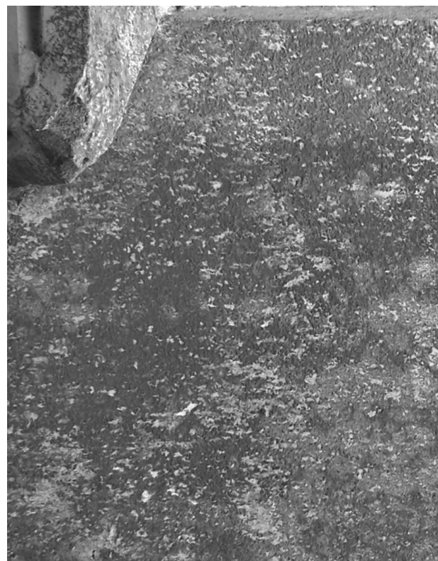
Detalle del muro exterior, se observa la colonización de líquenes.
