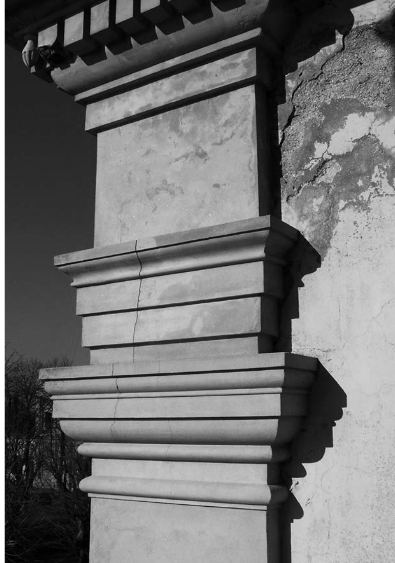
Vista de una fisura en uno de los ornamentos.
