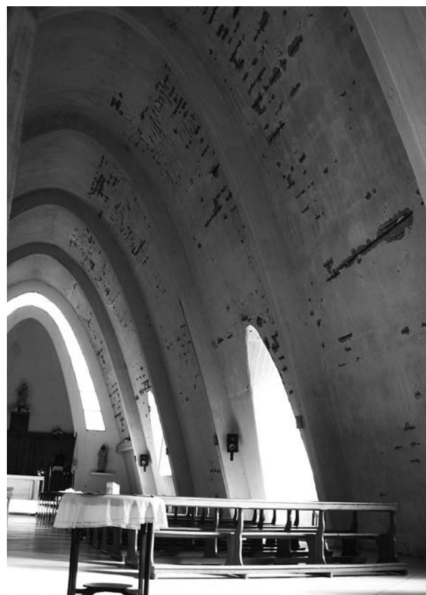
Detalle del interior de la Iglesia. Se observa el desprendimiento del recubrimiento.
