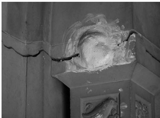
Detalle de una fisura. Se observa un testigo de yeso para registrar si la fisura continua activa.
