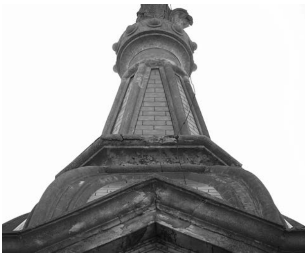
Detalle de la cubierta de la torre del campanario. Se observa una fisura y desprendimiento del material de recubrimiento por procesos de corrosión de elementos metálicos embutidos.
