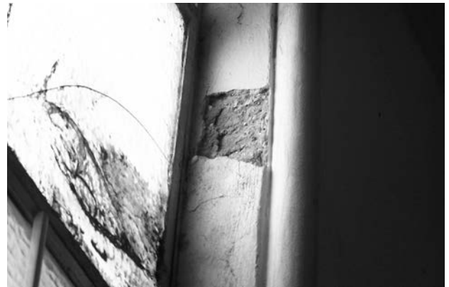
Detalle de desprendimiento de recubrimientos.
