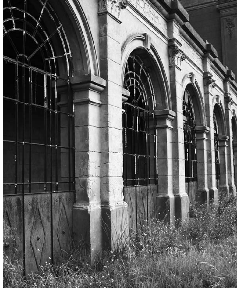
Vista de las aberturas de las galerías laterales. Se observa un proceso de corrosión superficial y la ausencia de vidrios.
