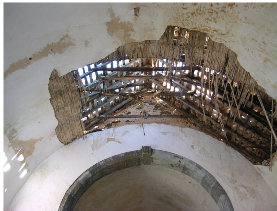
Foto 9. Aberturas na cobertura
