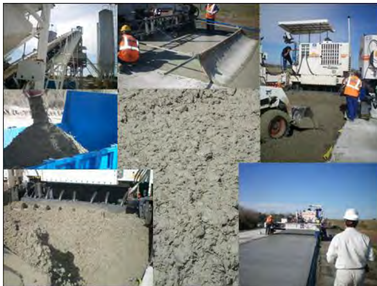
Figura 110. Empleo de macrofibras sintéticas en un whitetopping adherido empleado para la reparación y refuerzo de la ruta 24 en la República Oriental del Uruguay. Elaboración propia.
