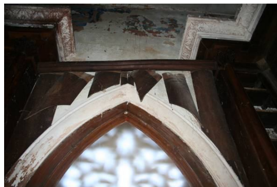
Fotografia 8. Pormenor do estado do revestimento dos vãos
