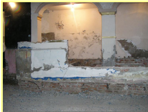
Fotografía N° 9: Estado de las paredes en salón principal.
