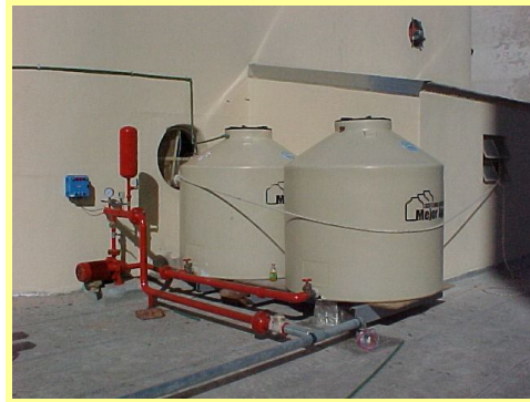
Fotografía 27: Equipamiento para protección contra incendio en azotea.
