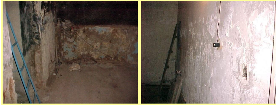
Fotografías N° 7 y 8: Aspecto de las paredes antes de la intervención.
