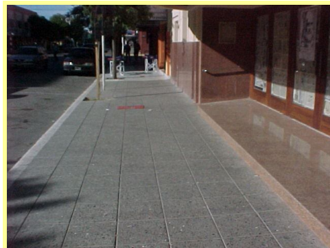
Fotografía N° 32: Detalle de losetas en vereda
