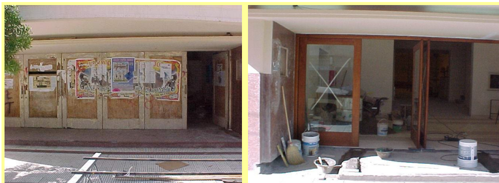
Fotografía 28 y 29: Vista de las puertas exteriores antes y después de la intervención.
