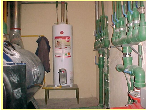
Fotografía N° 24: sala de máquinas y servicios.
