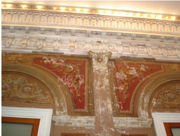
Eflorescencias salinas producidas por la humedad descendente
