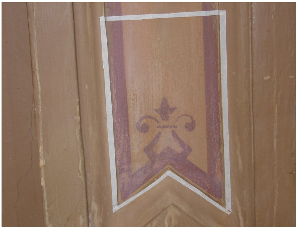
Se descubren guardas originales que se hallaban cubiertas de pintura
