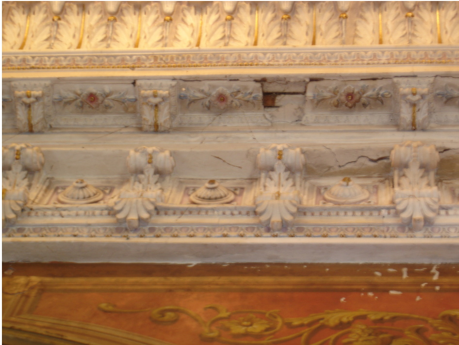
Desprendimientos en la yesería ornamental
