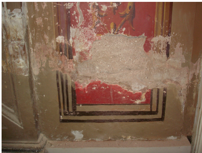
Eflorescencias salinas ascendentes que han hecho colapsar el material murario y la materia pictórica
