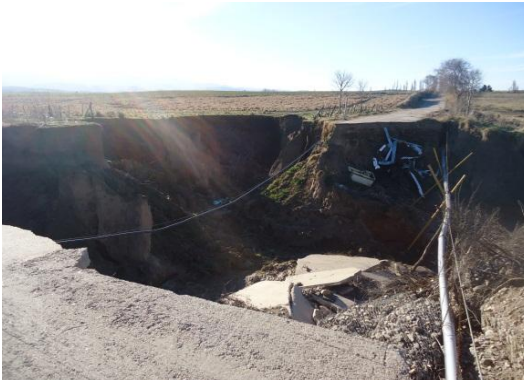
Figura 5. Camino vecinal arrasado por procesos sufusión.
