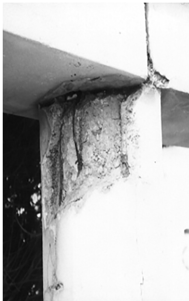
Columna con problemas de corrosión.
