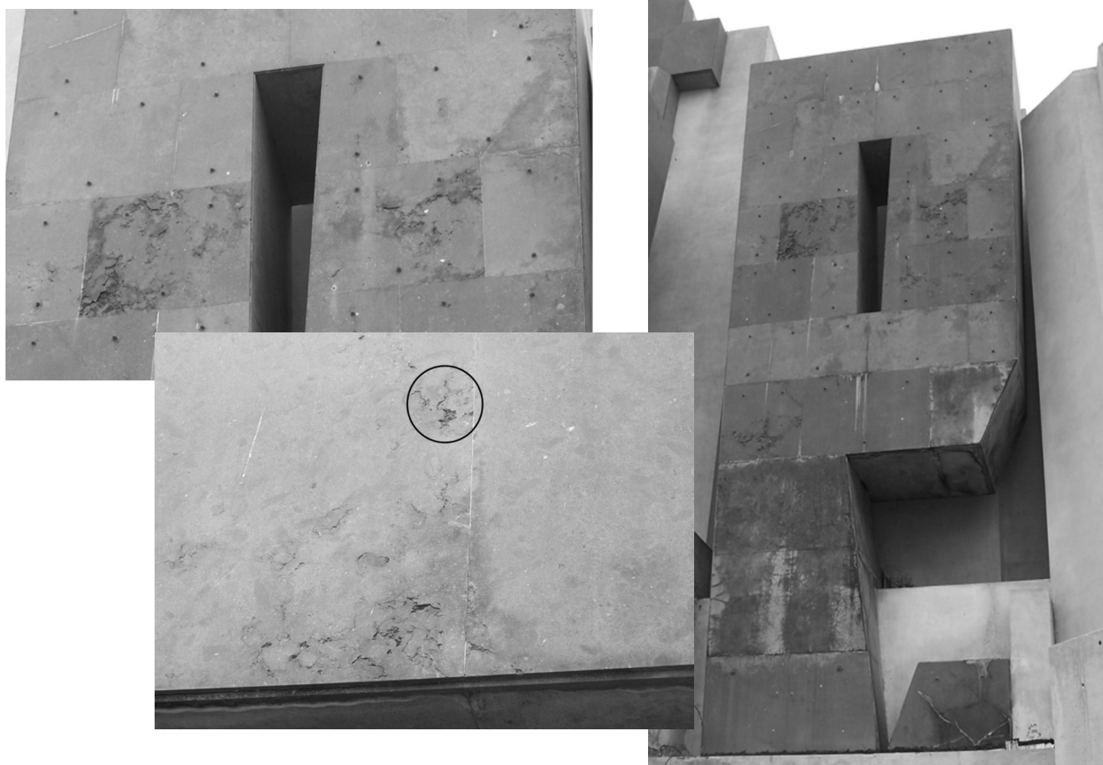
Detalle de un sector de la placa de revestimiento. Se observa núcleo o fragmento más oscuro con fisura/descascaramiento.
